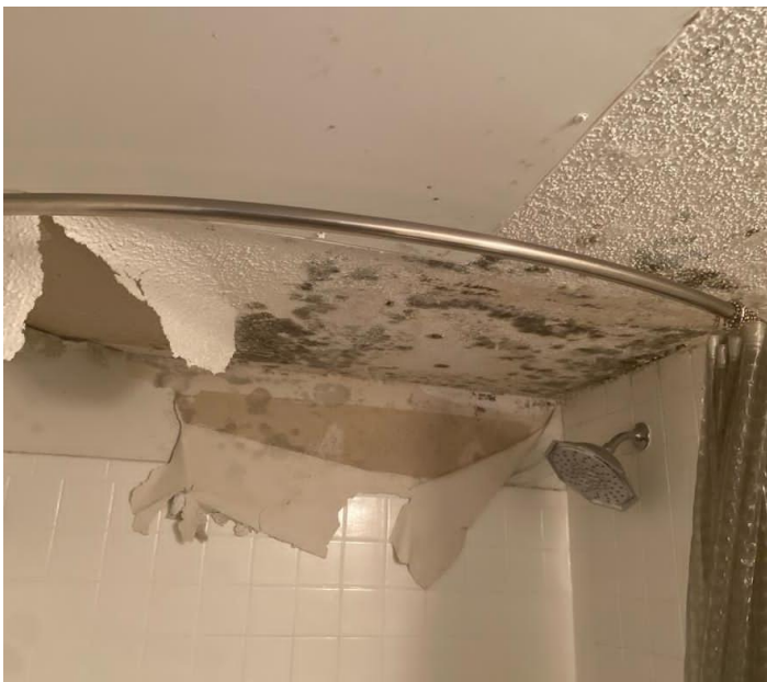
Figura 1: Una fuga de techo desatendida causa moho en el baño. Imagen: BASTA
